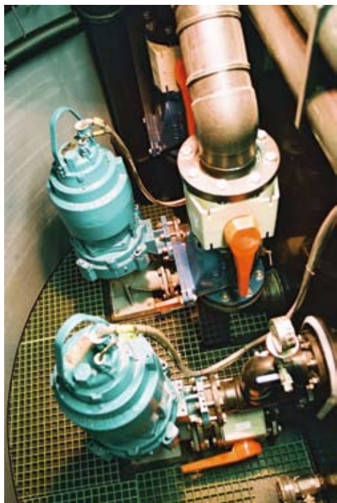
Een pompstelling in een grofvuilkamergemaal van A.S. Zwaans.
